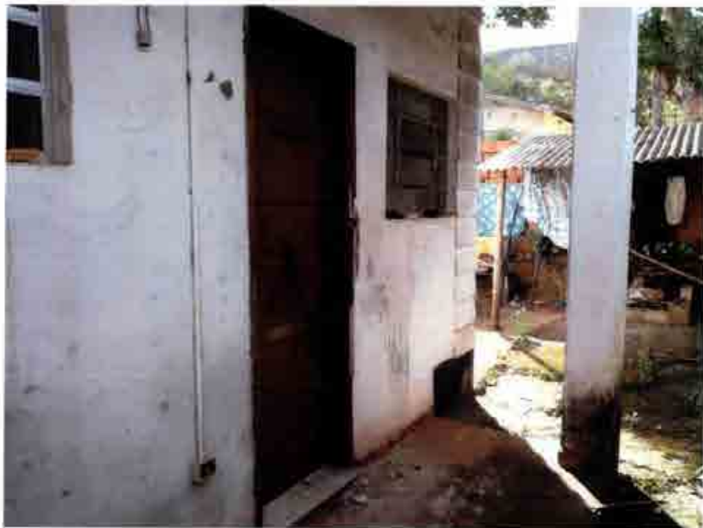
Foto 12: Vista da porta lateral onde foi feita tentativa de arrombamento.
