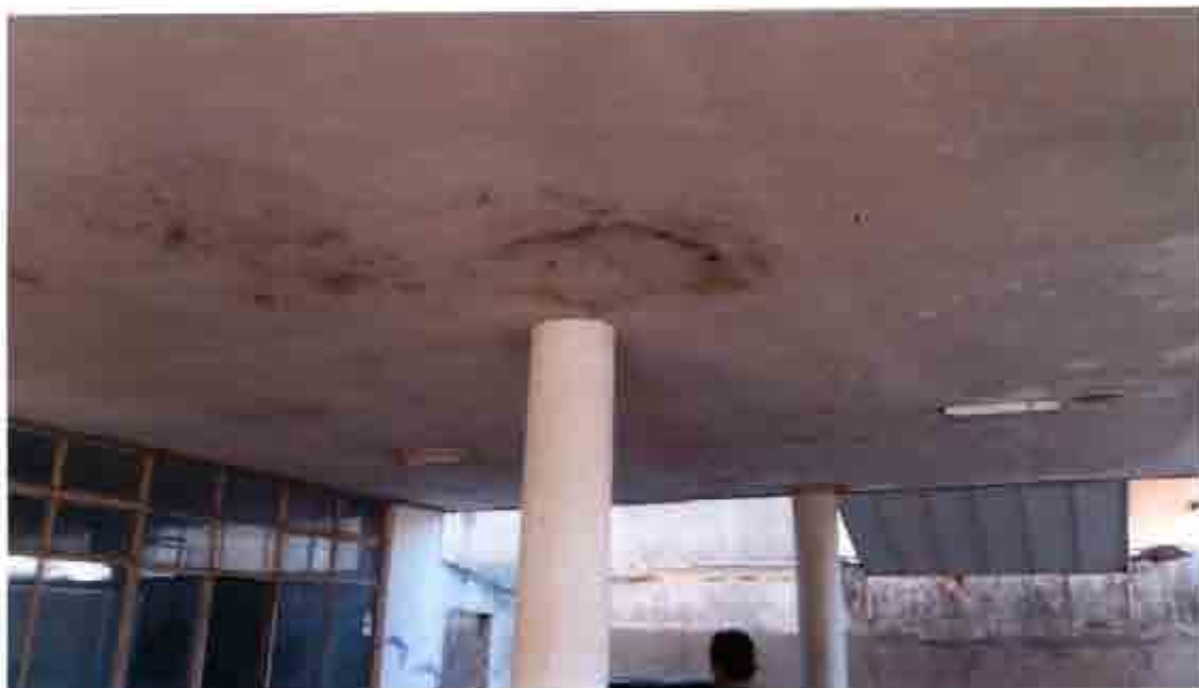
Foto 07: Cobertura da garagem apresentando manchas de infiltração.
