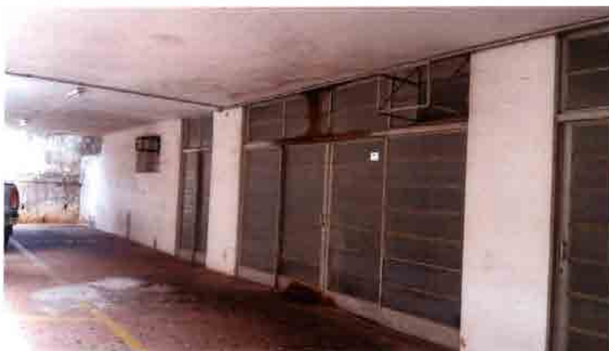
Foto 06: Esquadria da fachada degradada.
