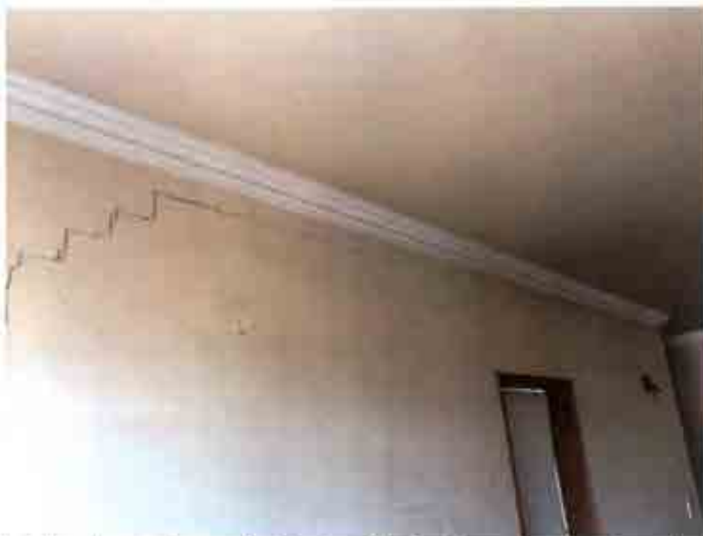
Foto 07 – Vista de parte interna do imóvel avaliando. Notar trincas nas alvenarias e lajes.
