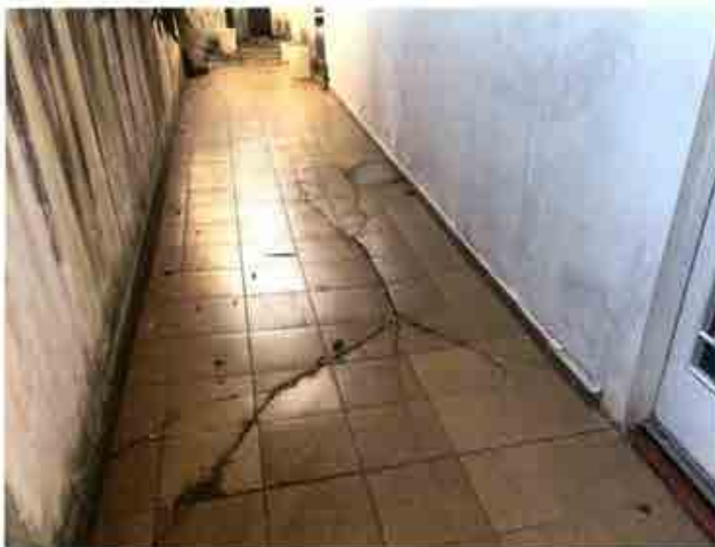
Foto 09 – Vista de parte interna do imóvel avaliando, circulação lateral esquerda. Notar trincas nos revestimentos de piso e abatimento do piso.
