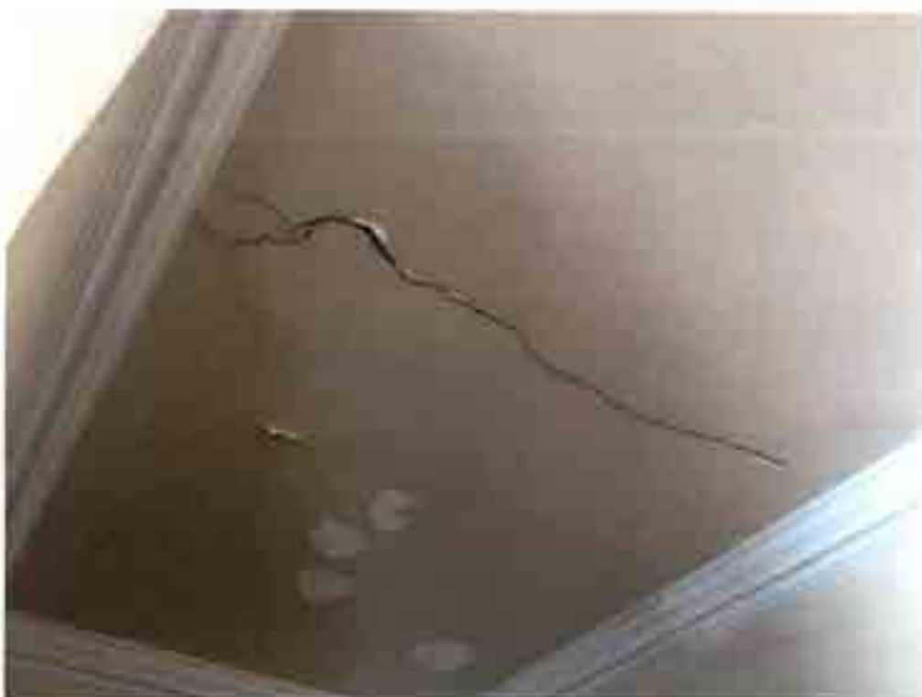
Foto 08 – Vista de parte interna do imóvel avaliando. Notar trincas nas alvenarias e lajes.
