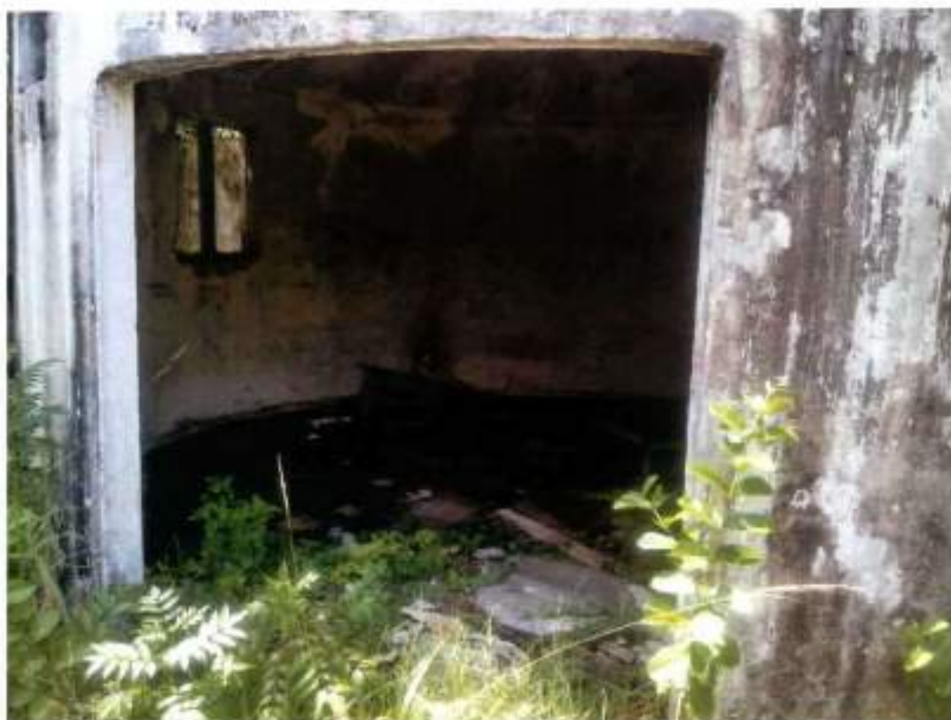
Foto 06: Construções em estado de grande degradação no interior do terreno.
