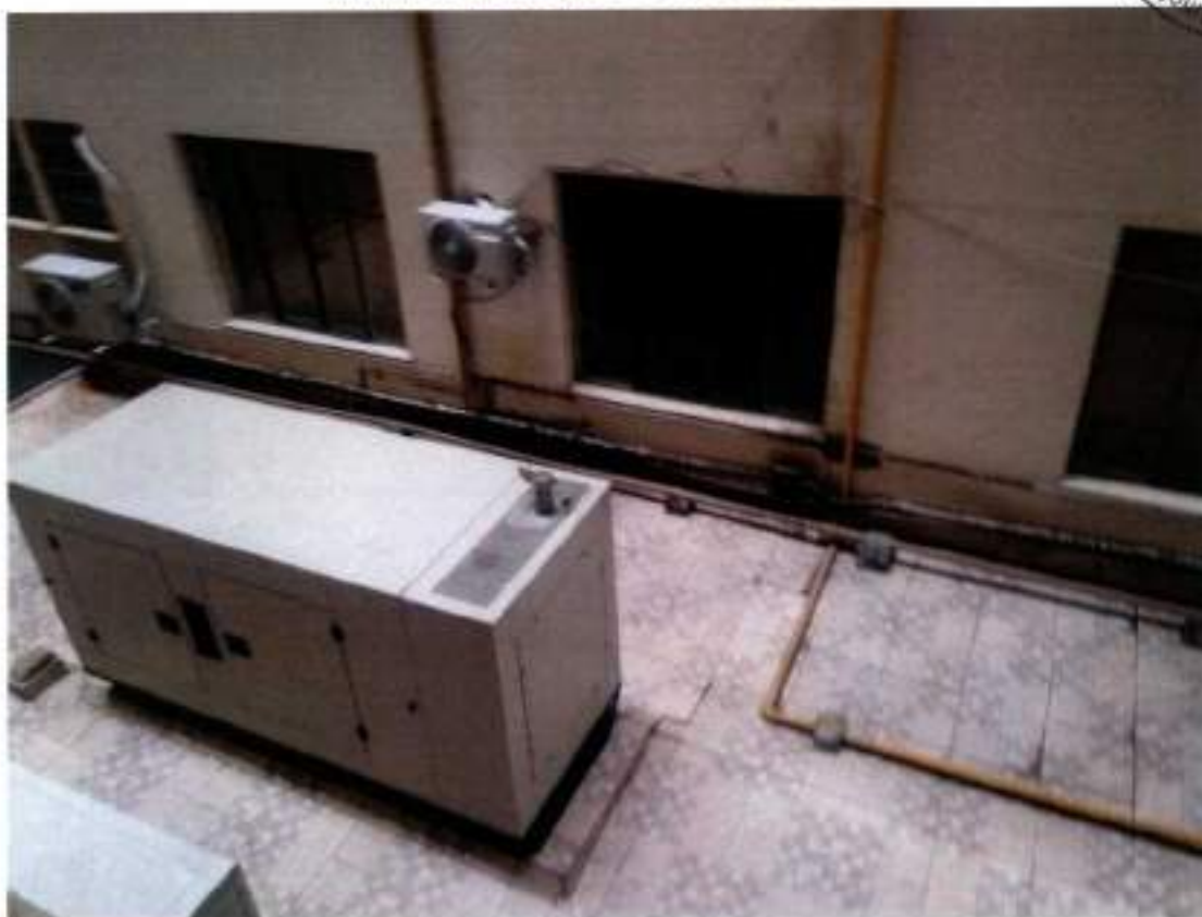
Foto 09: Gerador do condomínio.
