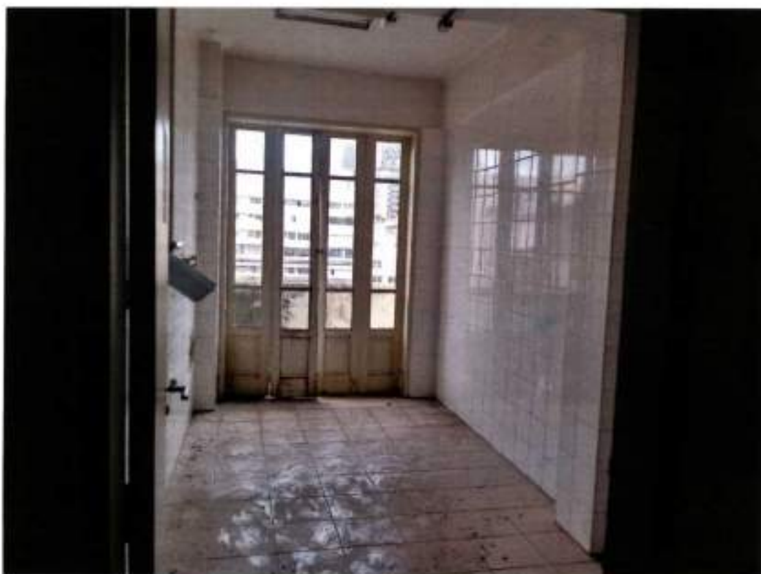
Foto 06: Copa necessitando de reforma, inclusive esquadrias.
