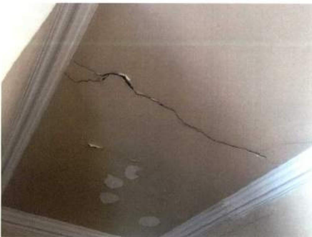
Foto 08 – Vista de parte interna do imóvel avaliando. Notar trincas nas alvenarias e lajes.
