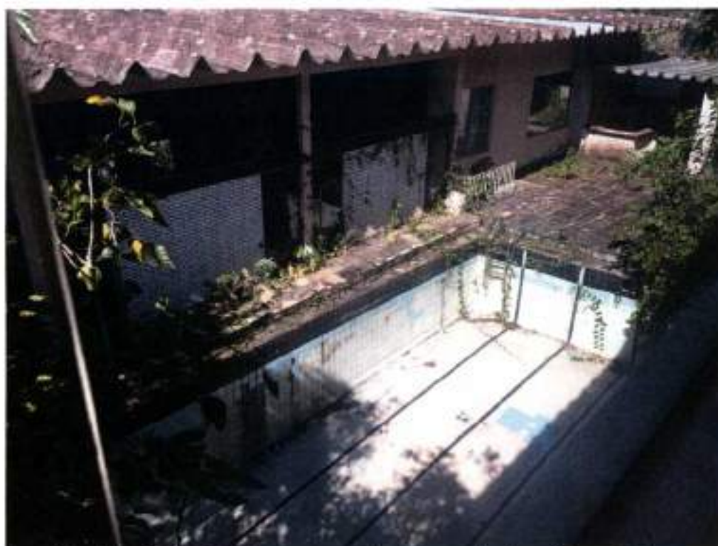
Foto 20 – Outra vista da mesma situação mostrada na foto anterior.
