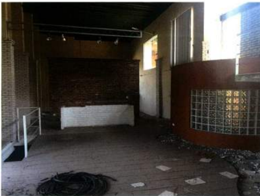
Foto 22 – Outra vista da mesma situação mostrada na foto anterior.
