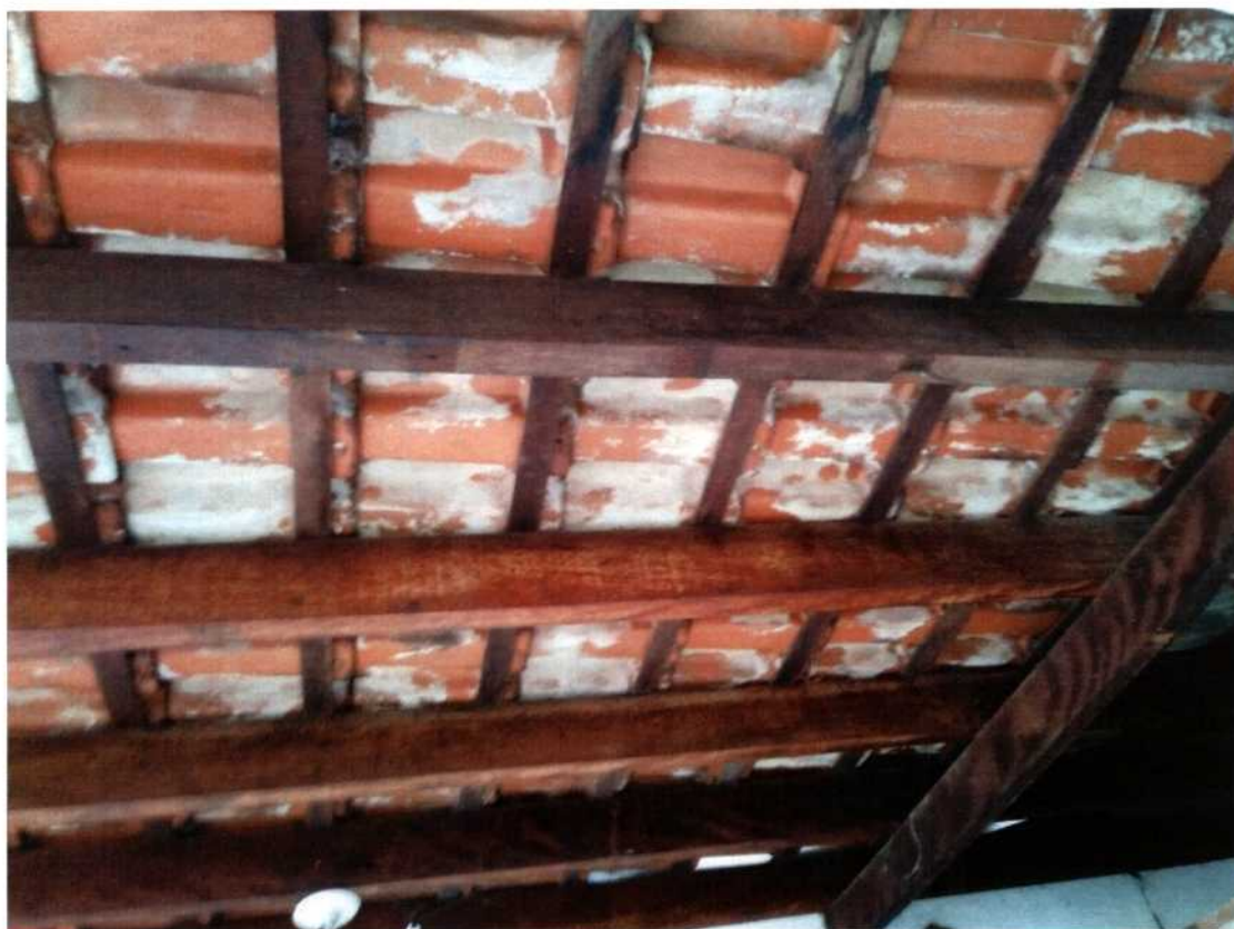
Foto 04: Telhas com mofo, apresentando problemas de infiltração.
