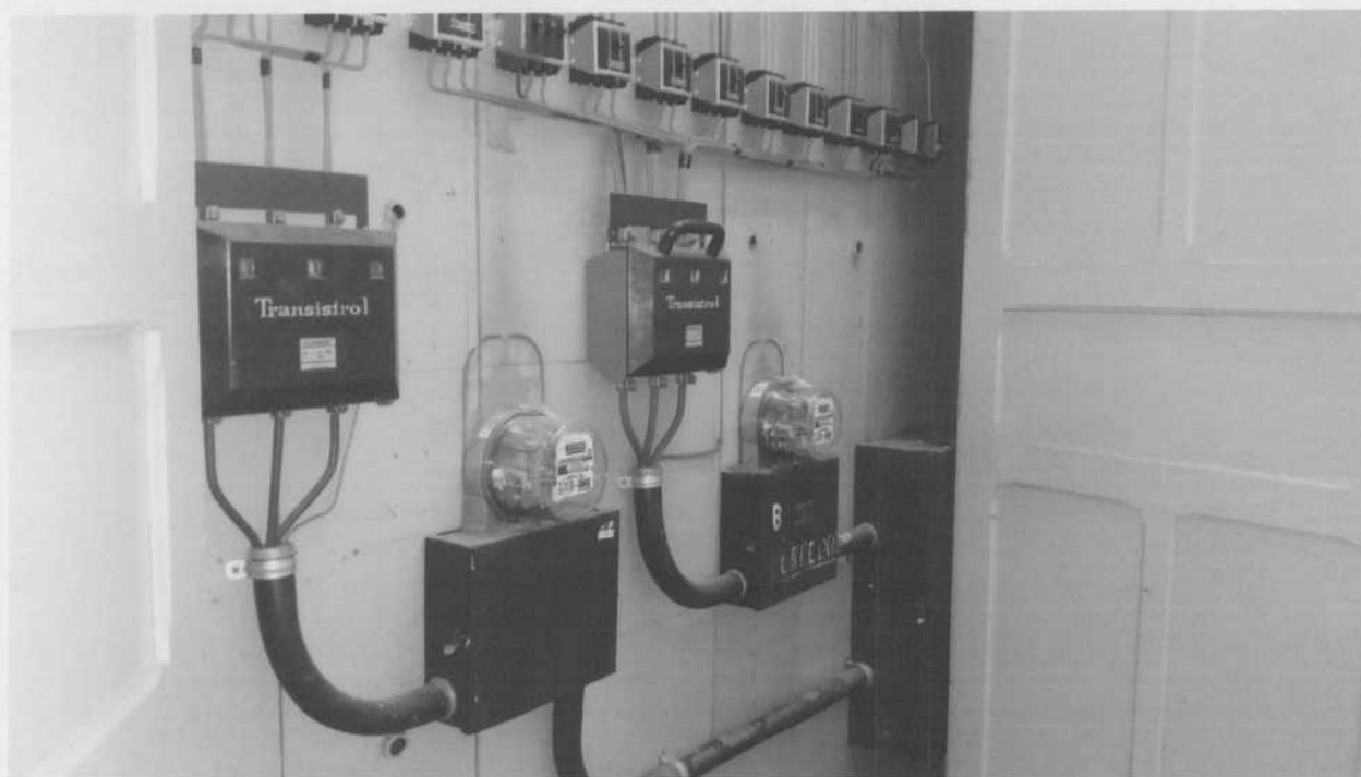
Foto 06: Quadro de entrada de energia.
