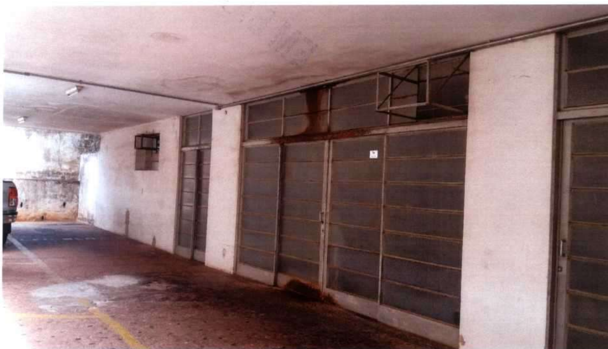
Foto 06: Esquadria da fachada degradada.
