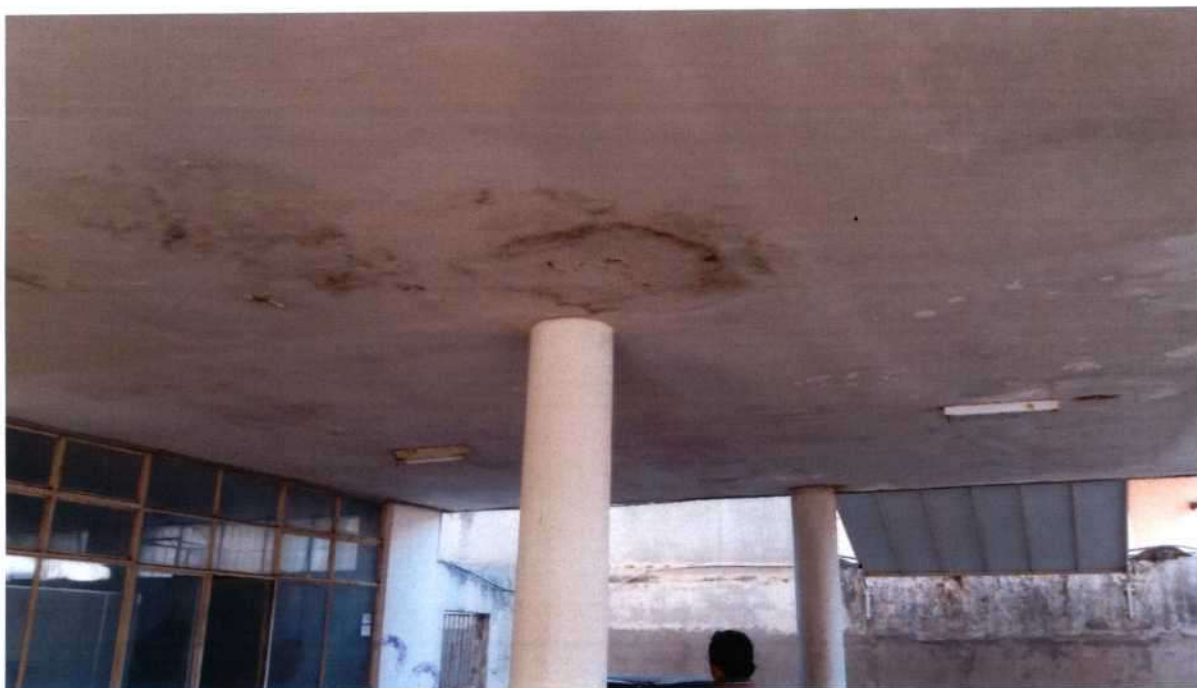
Foto 07: Cobertura da garagem apresentando manchas de infiltração.
